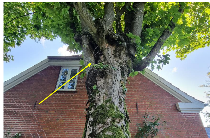
Ahorn med hulheder ved vestgavl
