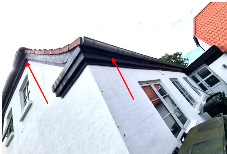
Beboelse øst facade. Spalter mellem tag og mur
