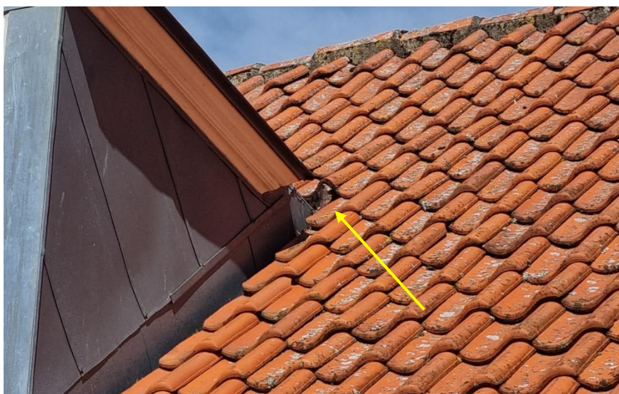
Hul mellem tagplade og afdækning – tag sydside
