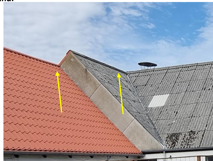
Lade bygning øst side, huller og spalter ved bygnings overgang og rygning
