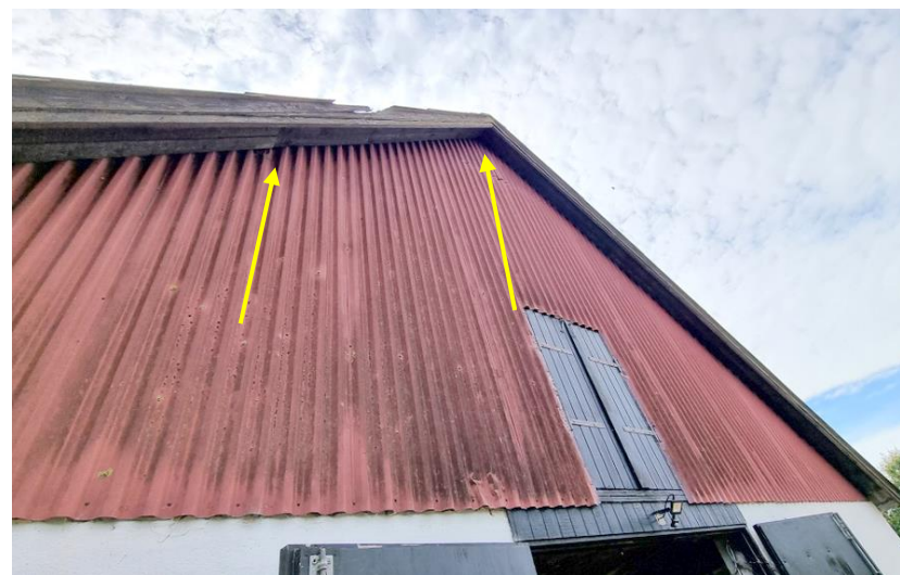
Hestestald nordside. Huller mellem plader og gavl.
